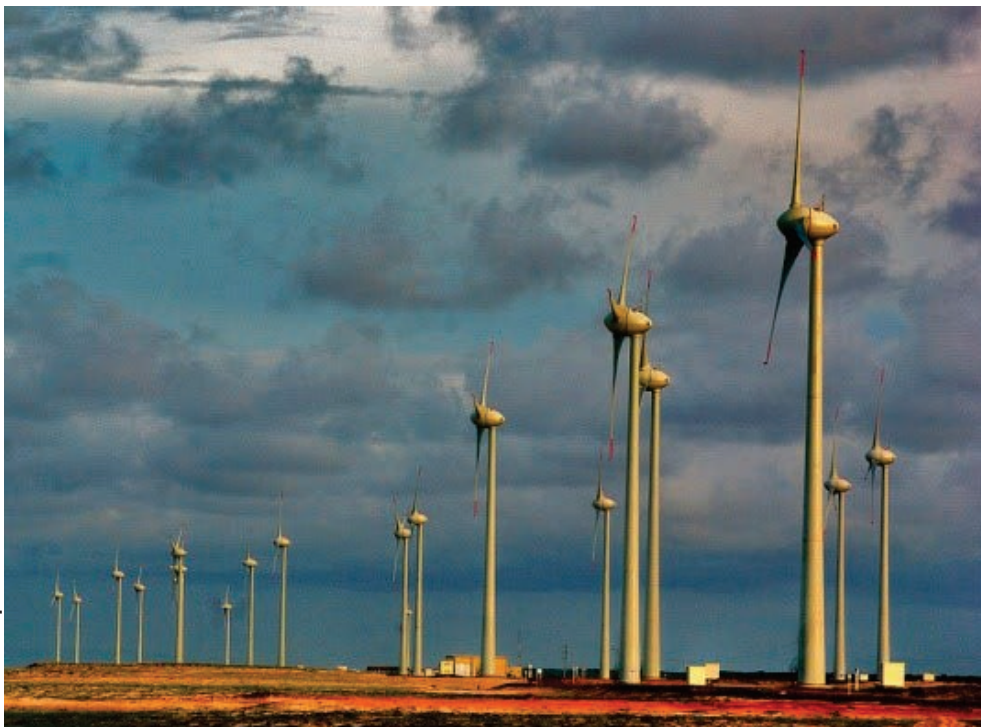
Parque eólico em Parnaíba, Piauí
