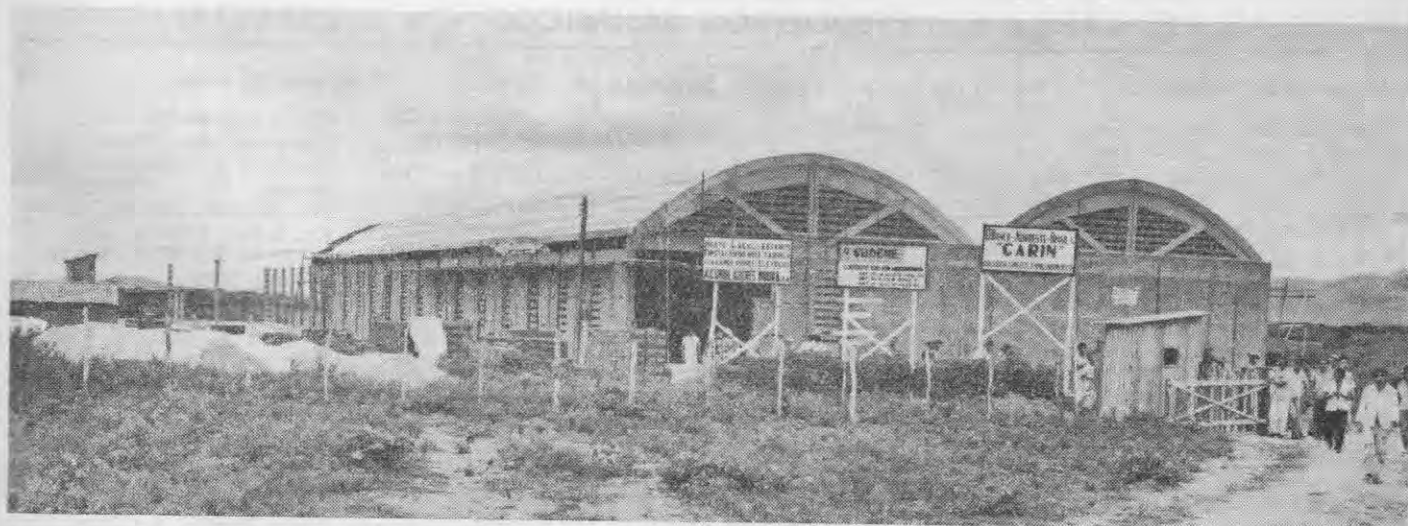
Fotografia da nova fábrica de Acumuladores Moura S. A., em Belo Jardim, Pernambuco. — A fotografia foi tirada na fase inicial de construção. Hoje, a área coberta é de cerca de 4 000 metros quadrados, estando concluídas as obras de construção.
