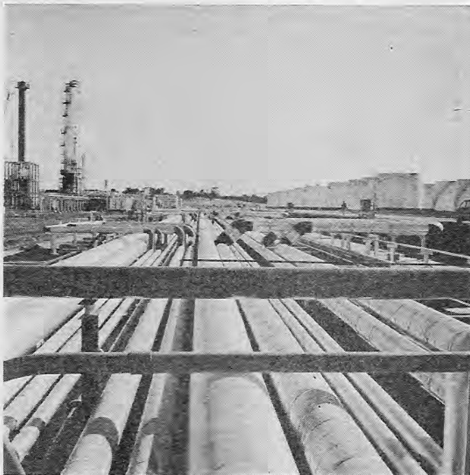
No primeiro plano: instalações do oleoduto. Ao fundo: parte da refinaria.
