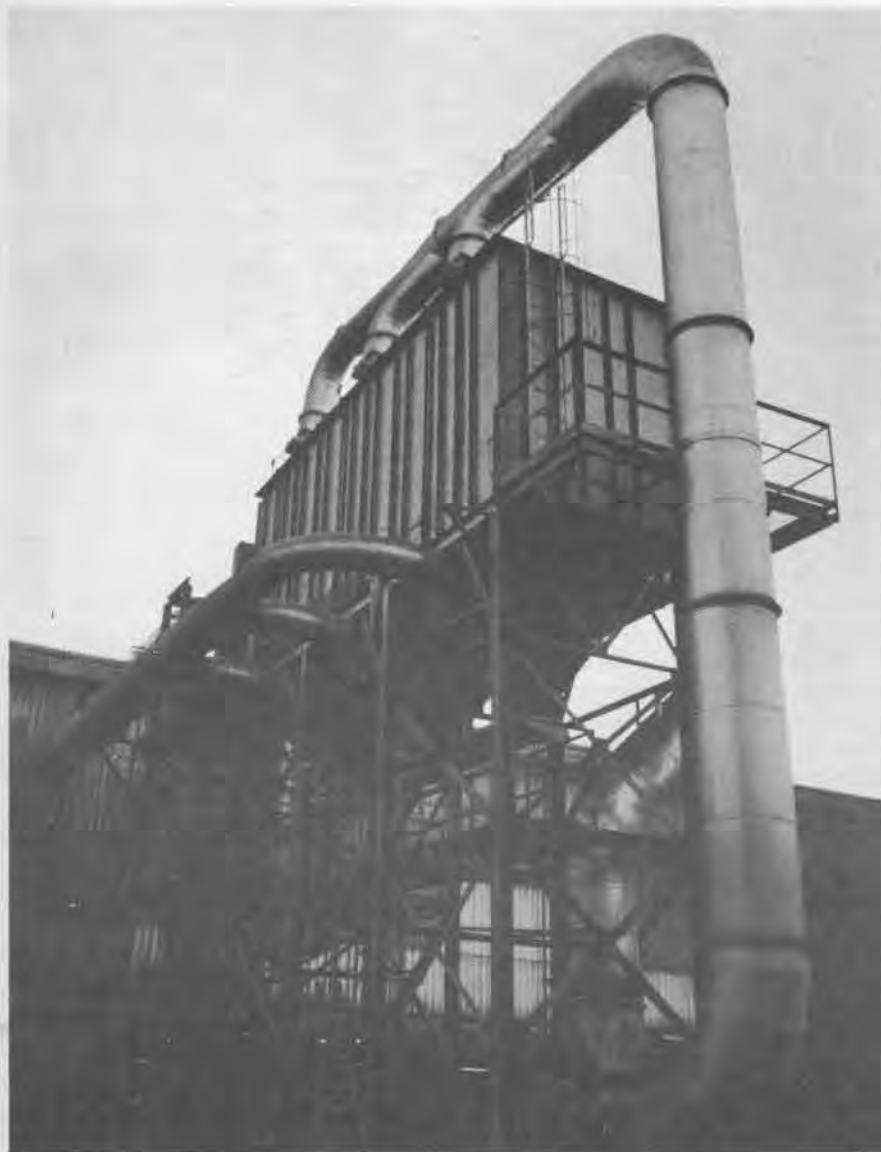
Equipamento de filtragem de ar.
