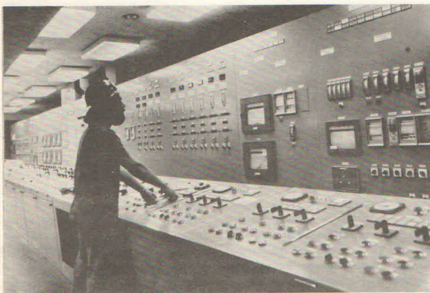
Sala de controle das operações do alto-forno Nº 2.
