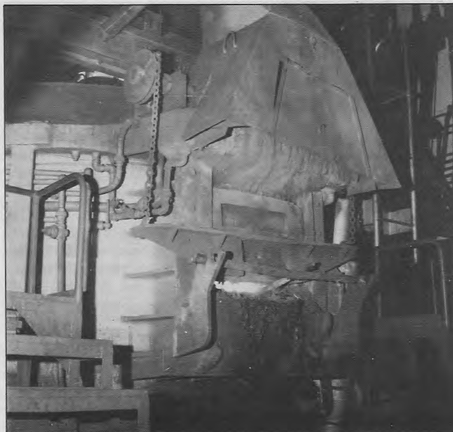
O imenso coletor suga toda a fumaça pouco acima da boca do torno impedindo a poluição do ambiente. (Usina da fábrica)
