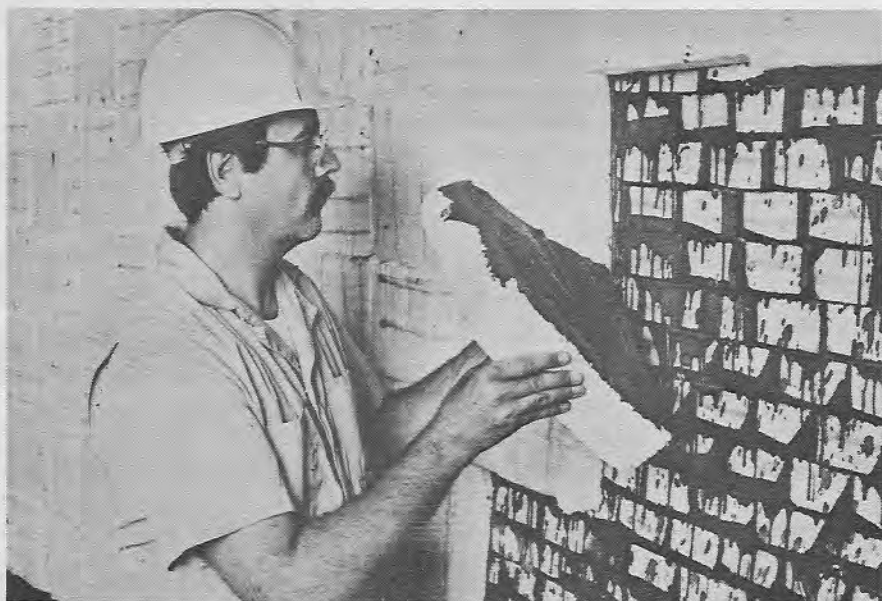
Módulos de fibra cerâmica são facilmente cimentados sobre os tijolos refratários existentes.
