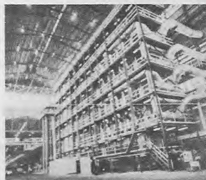
Linha de galvanização contínua
