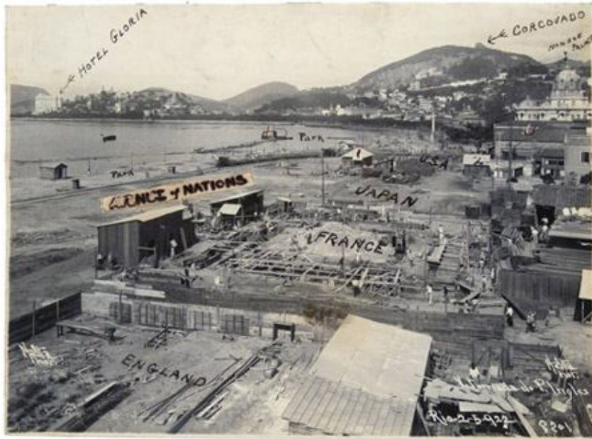
Figura 13. - Canteiro de obras dos pavilhões das Nações. Foto de Augusto Malta, 1922. Disponível em http://bndigital.bn.br/redememoria/galerias/maltaMHN/index.htm
